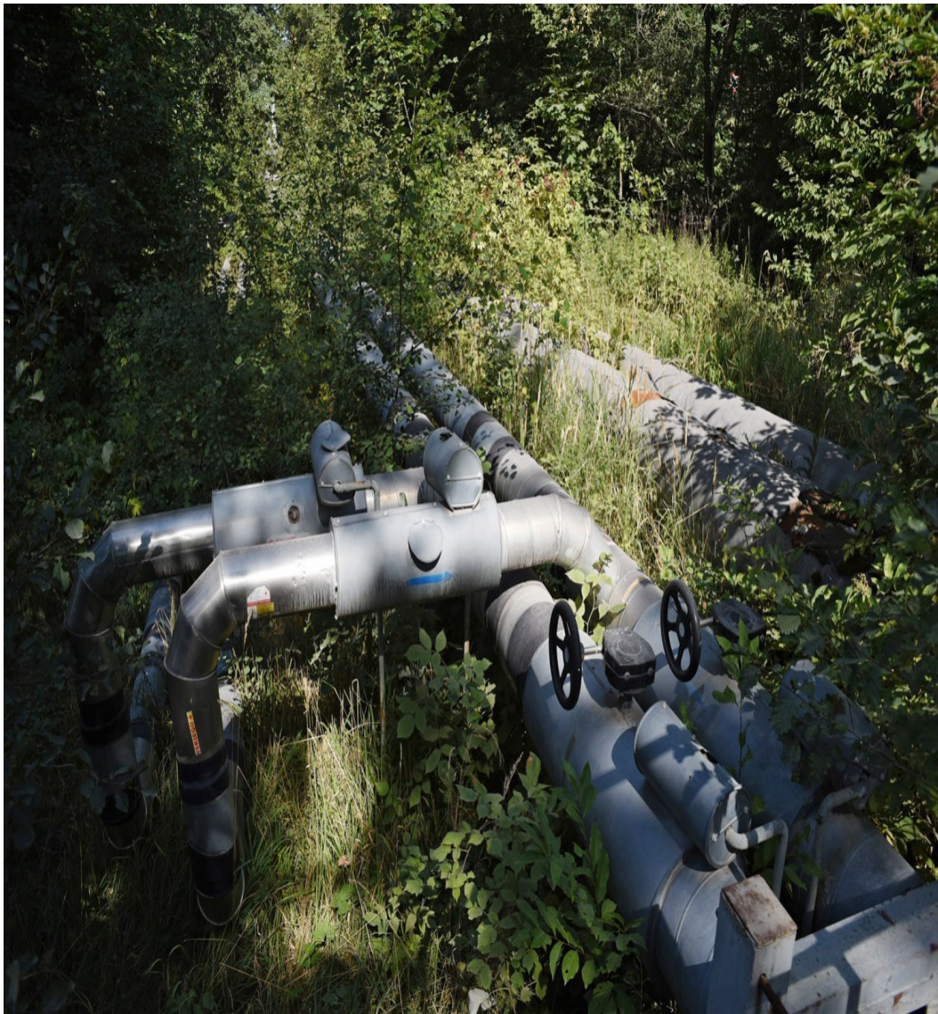
Canalisations destinées à l'alimentation en eau de la mine.
